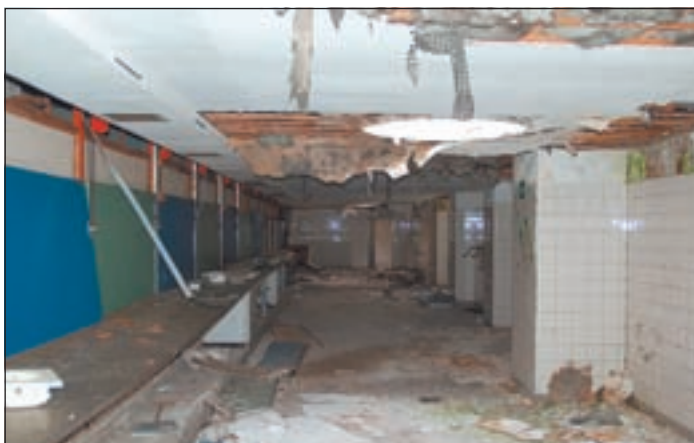
Vandalismus, Diebstahl und Verfall haben aus vielen Gebäuden der Röttiger-Kaserne Ruinen gemacht.
