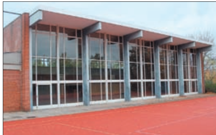
Auch die Turnhalle am Opferberg ist zur Zeit wegen möglicher Asbestbelastungen geschlossen. Fotos: Koltermann
