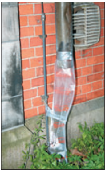
Provisorische Lösung: Plastikschi-läuche statt Fallrohre Foto: Müntz
