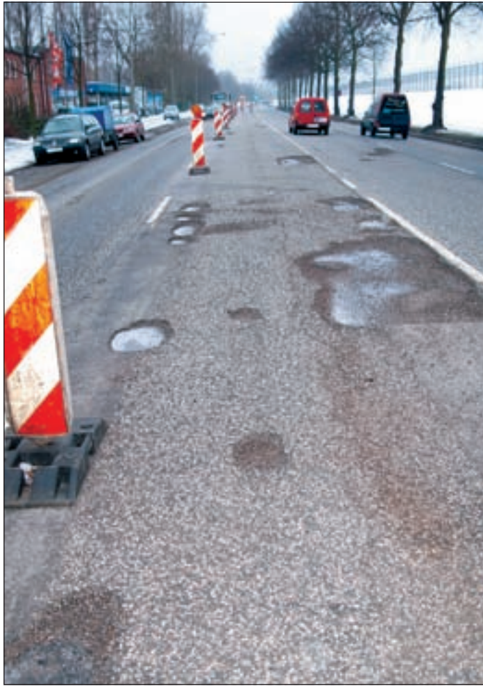
Riesige Schlaglöcher machen das Fahren auf Wilhelmsburgs Straßen zu einem gefährlichen Unternehmen. Foto: Ubben
