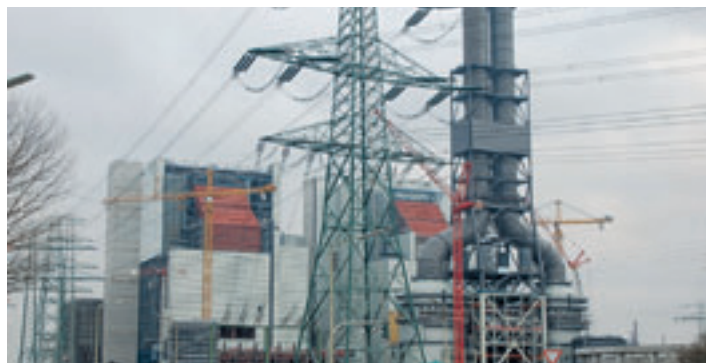
Aufgrund schadhafter Schweißnähte in den Druckkesseln, soll sich laut Betreiber Vattenfall die Inbetriebnahme verzögern. Foto: mk
