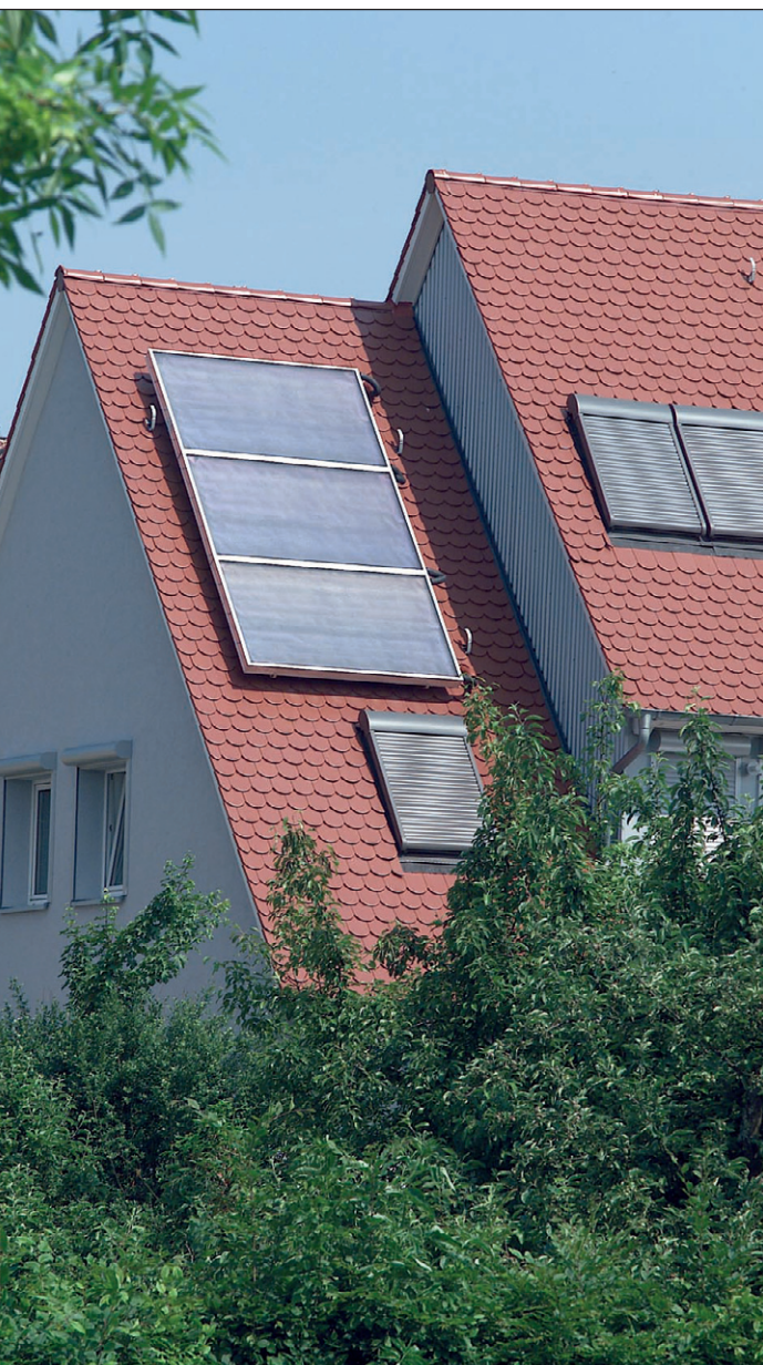
Das Kraftwerk auf dem Dach: Der Staat fördert Investitionen in Zelle und Kollektoren
