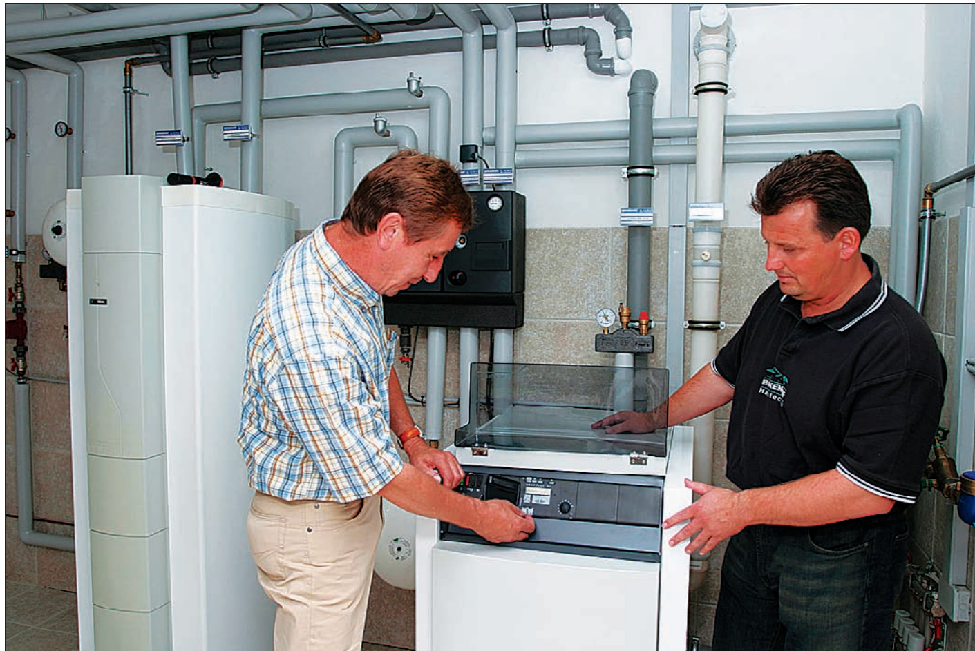
Mit einer bodenstehenden Öl-Brennwertanlage mit Solarspeicher können Hausbesitzer ihre Heizkosten nachhaltig mindern.
