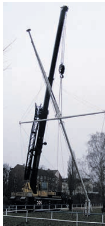
Ein großer Autokran ist notwendig, weil der 20 Meter lange Flaggenmast umgelegt werden musste
