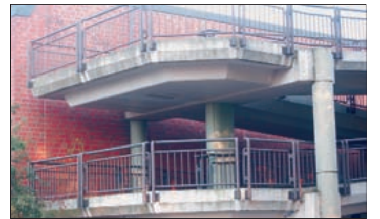
Von der sich in Serpentinaen windenden Fortsetzung der Fußgängerbrücke auf Höhe des Parkhauses soll nach den Vorstellungen von Politikern und Städteplanern eine Rampe in den zukünftigen „NF-65“-Park führen. Fotos: Koltermann
