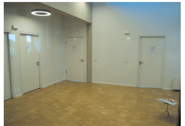
Der komplette Parkettfußboden des Familienzentrums muss ausgetauscht werden. Foto: mk
