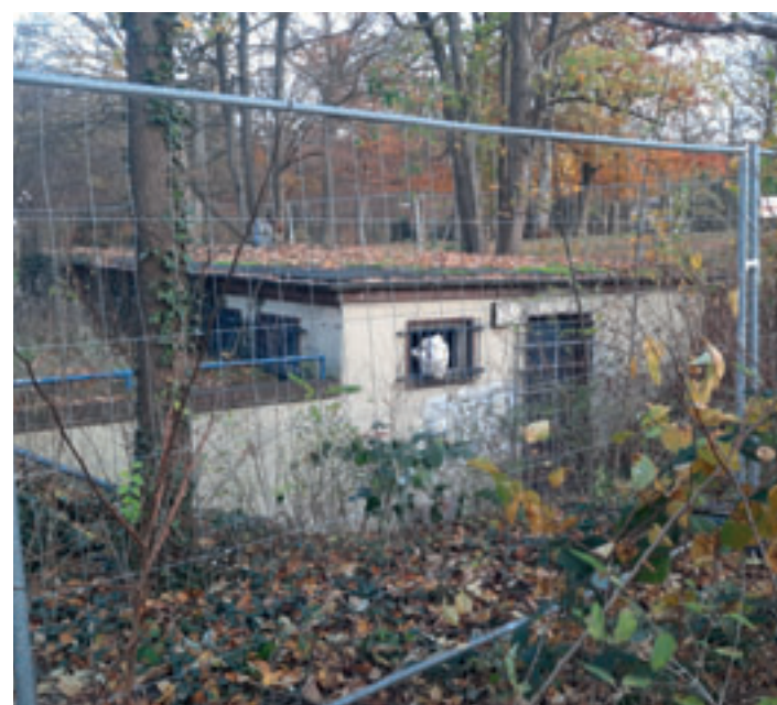
Das ehemalige Toilettenhäuschen des Schwarzenbergparks soll laut Auskunft des Bau-Dezernates abgerissen werden. Foto: M. Hoschützky
