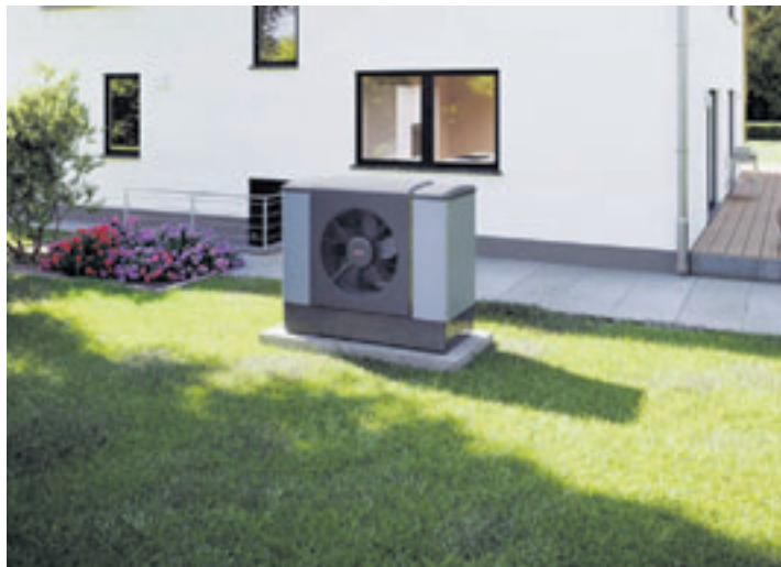
Mehr als 1.000 Kund:innen haben sich deshalb bereits für eine Wärmepumpe und eine PV-Anlage von heimWatt entschieden
