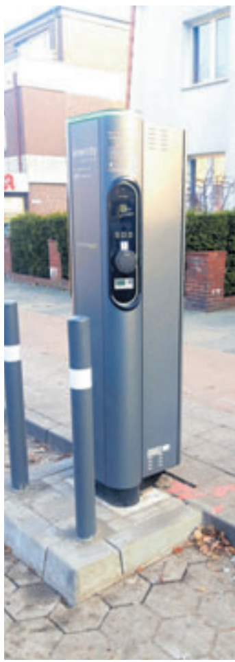
Die konkrete Auswahl der Parkflächen, auf denen Ladesäulen errichtet werden sollen, erfolgt durch die jeweiligen Betreiber
