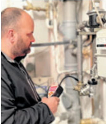
Sicher und störungsfrei heizen mit Gas: Jetzt kommen wieder Prüfer der Hamburger Energienetze ins Haus und checken die im Gebäude liegenden Teile des Gasanschlusses Foto: Hamburger Energienetze
