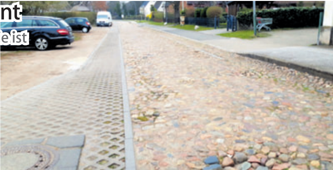
Laut Aussage des Bezirksamtes seien größere bauliche Maßnahmen oder umfassende Instandsetzungen in der Straße Im Neugrabener Dorf nicht geplant Foto: W. Marsand
