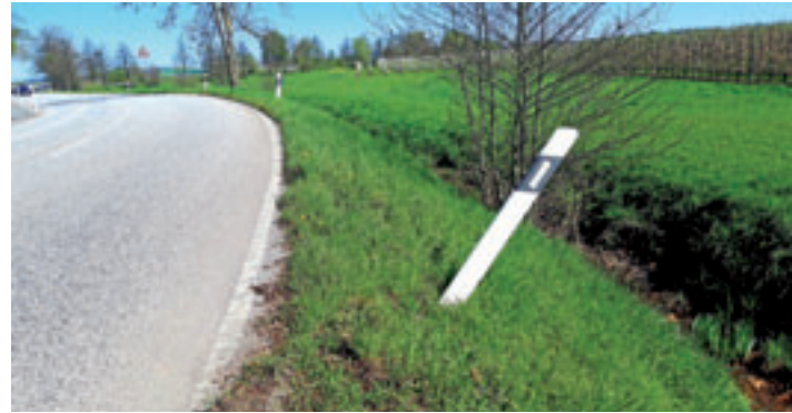
Die FDP fordert die Instandsetzung der Leitpfosten entlang des Nincoper Deiches Foto: W. Marsand
